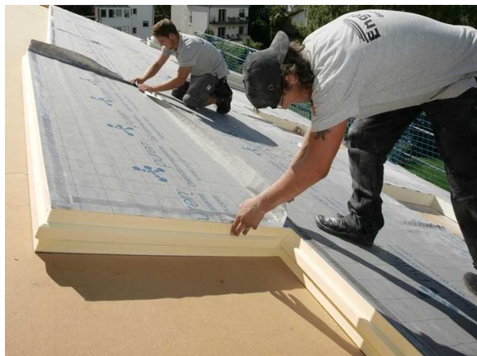
Fig. 7: Installation of PU rigid foam panels as above-rafter insulation. Source: Baustoffwissen, RM Handelsmedien GmbH & Co. KG: Dämmstoffe, Einsatzbereiche von PU-Hartschaum. URL: https://www.baustoffwissen.de/baustoffe/baustoffknowhow/daemmstoffe/pu-hartschaum-polyurethan-daemmstoff-platten-einsatzbereiche-dach-boden-wand-wdvs-brandriegel-sandwich-elemente/ [Accessed: 14.06.2023]
